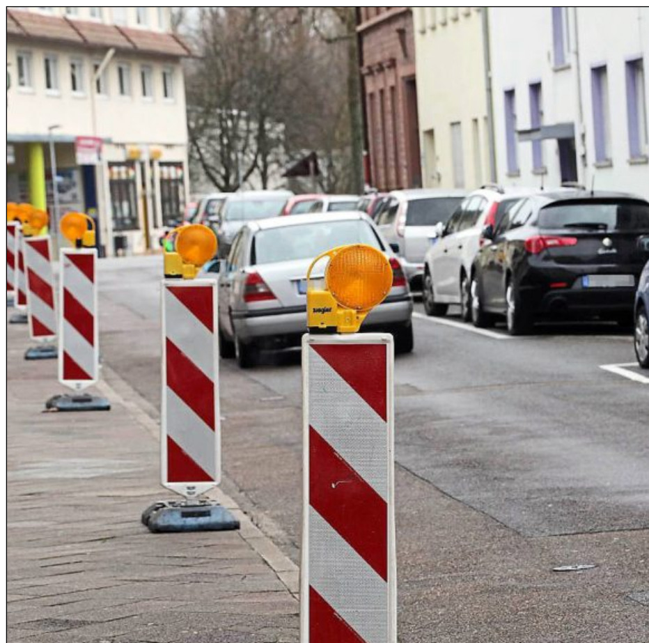
EIGENS AUFGESTELLTE BAKEN sollen nun entgegenkommende Autofahrer in der Forststraße in Rintheim daran hindern, auf den Gehweg auszuweichen. Foto: jodo
